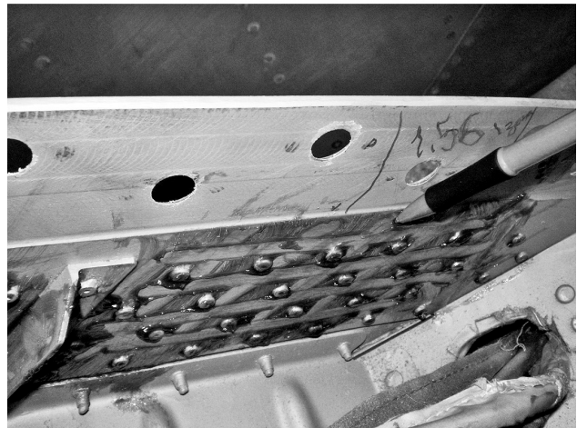
Рис. 6. Місця конструкції, де спостерігається стоншення матеріалу стикових накладок кіля, спричинені корозійними ураженнями
