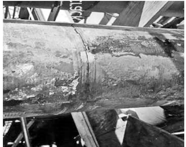
Рис. 2. Тріщина в зварному шві труби \varnothing 219 \times 6 мм із сталі 20, яка утворилась від непровару кореня шва та вийшла на поверхню труби
