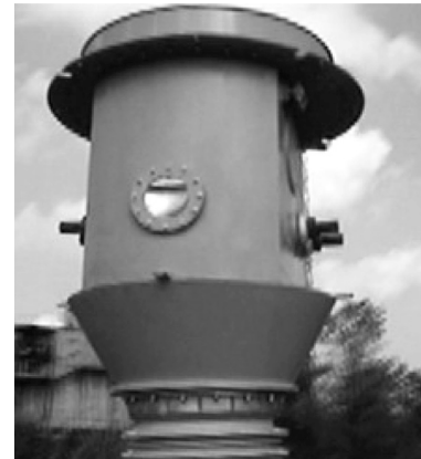
Рис. 2. Верхняя часть трансформатора с разгрузочными мембранами
