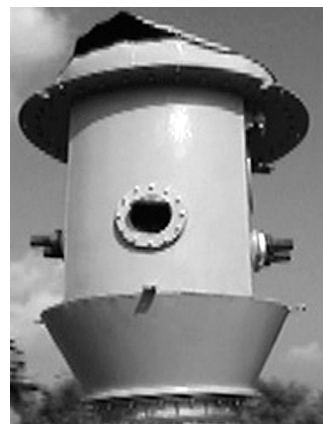
Рис. 10. Верхняя часть трансформатора после испытаний
